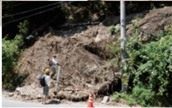
水路が崩壊した小水力発電施設(庄原市西城町)
